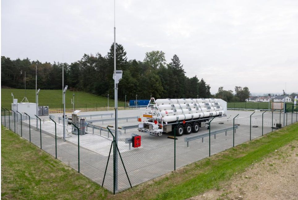
H2-direkt: Einspeiseanlage der ESB
